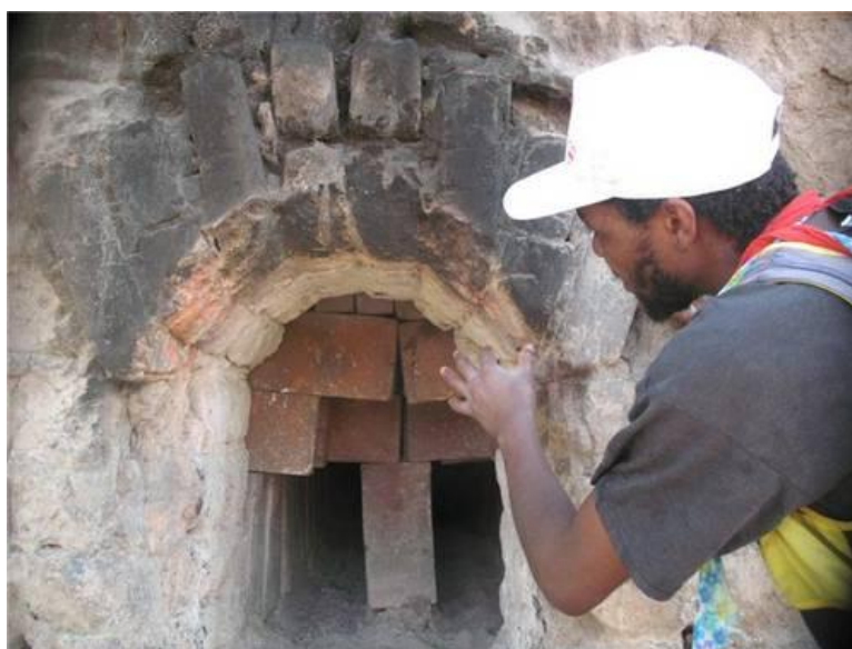
Fotografía 26: Caldera de Horno-Quito
